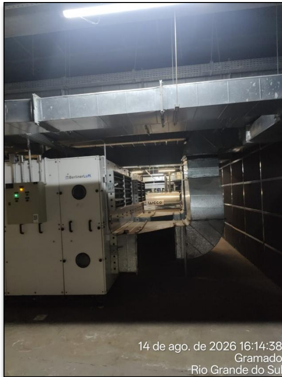
48. Sistema de bombas
