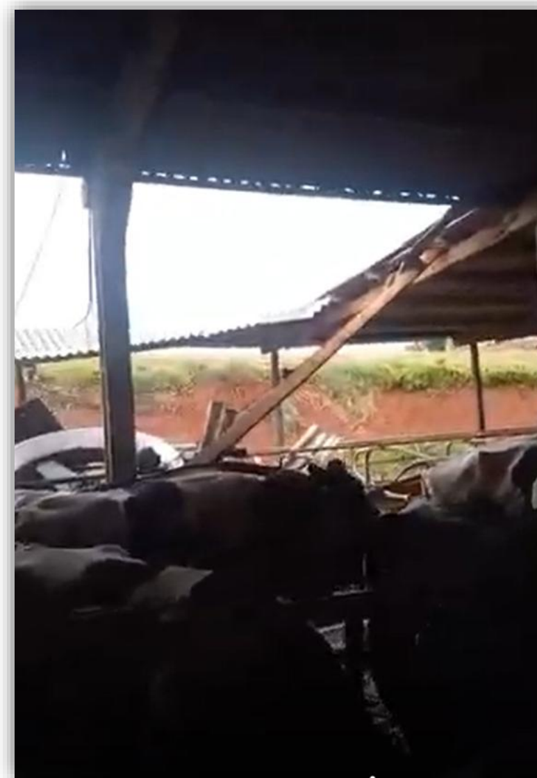
Figura 7: Estrutura de confinamento totalmente danificada.
