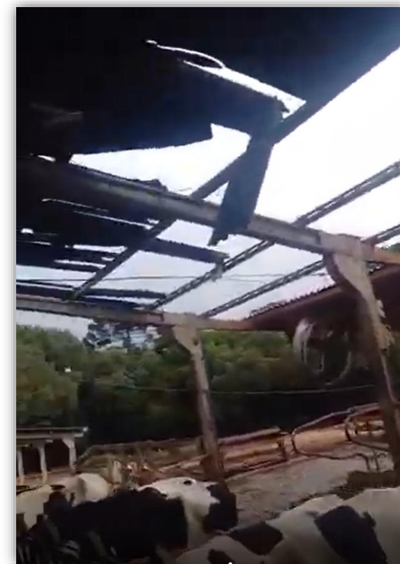
Figura 8: Estrutura e ventilador danificados
