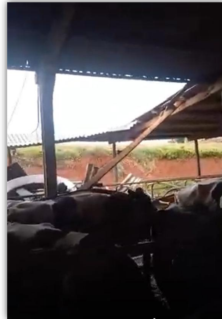
Figura 7: Estrutura de confinamento totalmente danificada.
