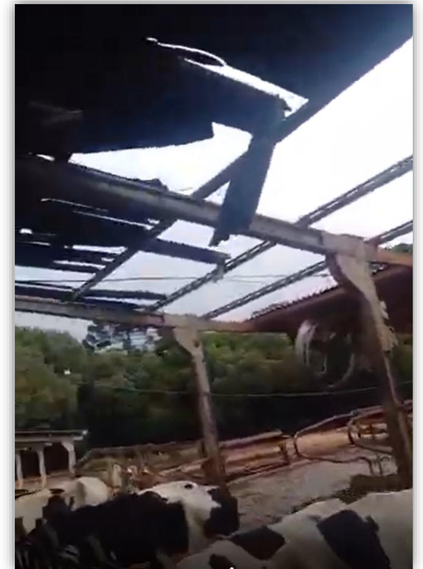
Figura 8: Estrutura e ventilador danificados
