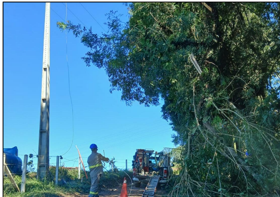
01. Árvore caída em decorrência de tempestade
