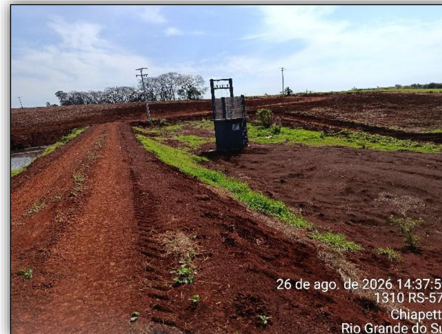
5. Transformador de energia do sistema de irrigação
