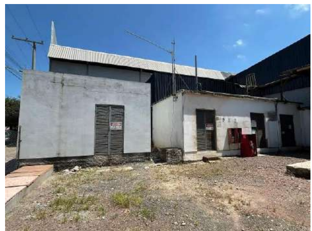
Vista externa – subestação e gerador
