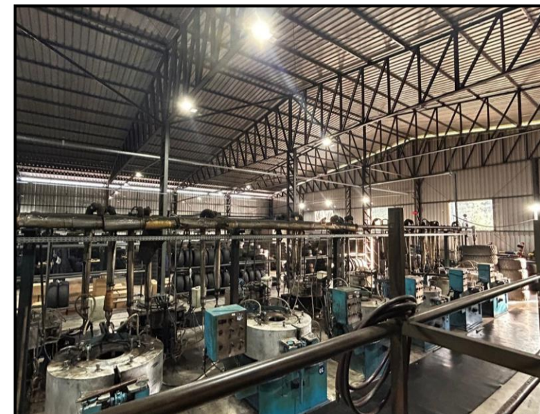
04. Máquinas e equipamentos (Rua Tiradentes, nº 601)
