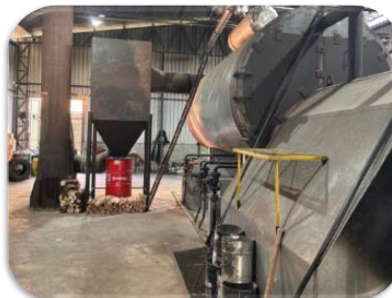
05. Máquinas e equipamentos (Rua Tiradentes, nº 601)
