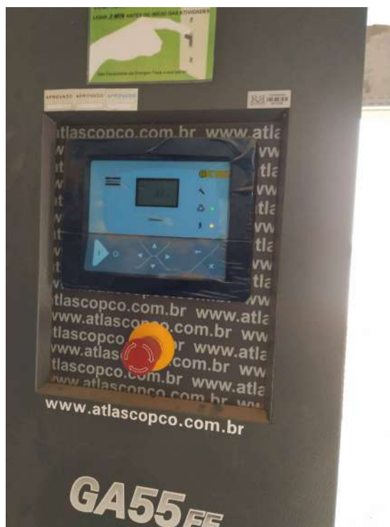
Foto 06: COMPRESSOR ESTACIONARIO GA55 150 AFF
