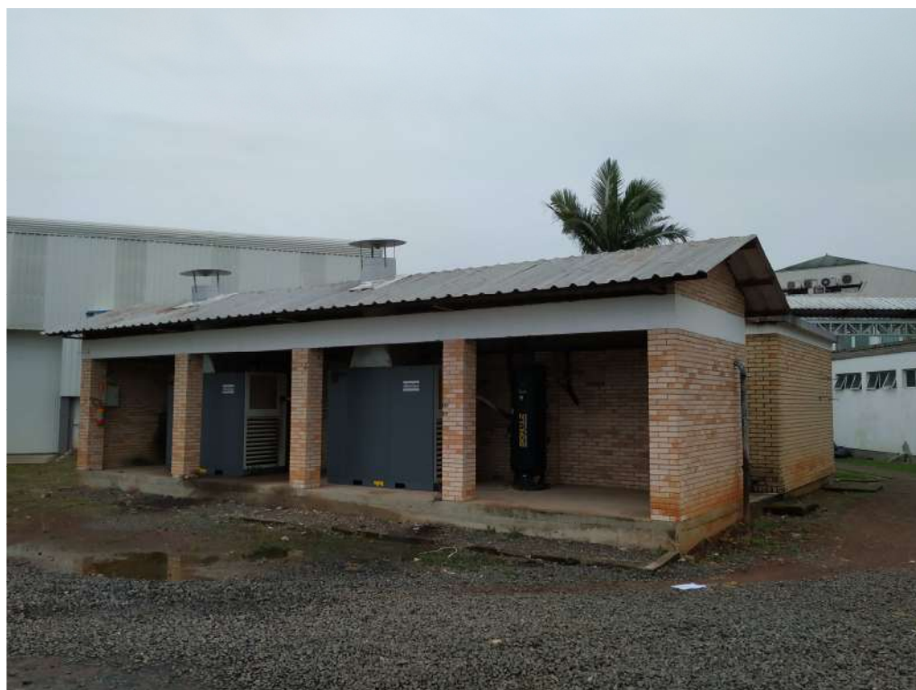
Foto 28: Local destinado aos compressores
