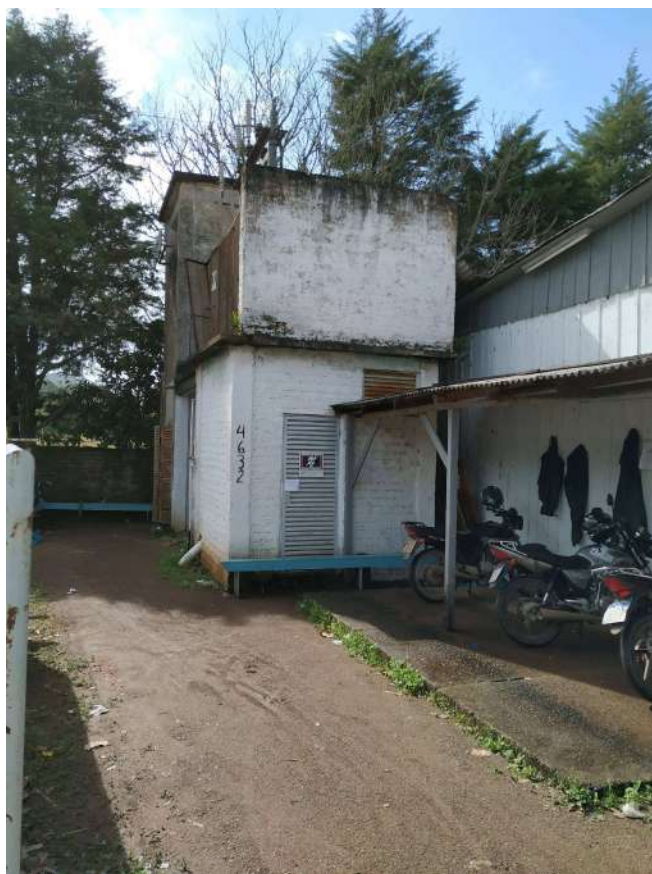
Foto 73: Detalha do transformador de entrada
