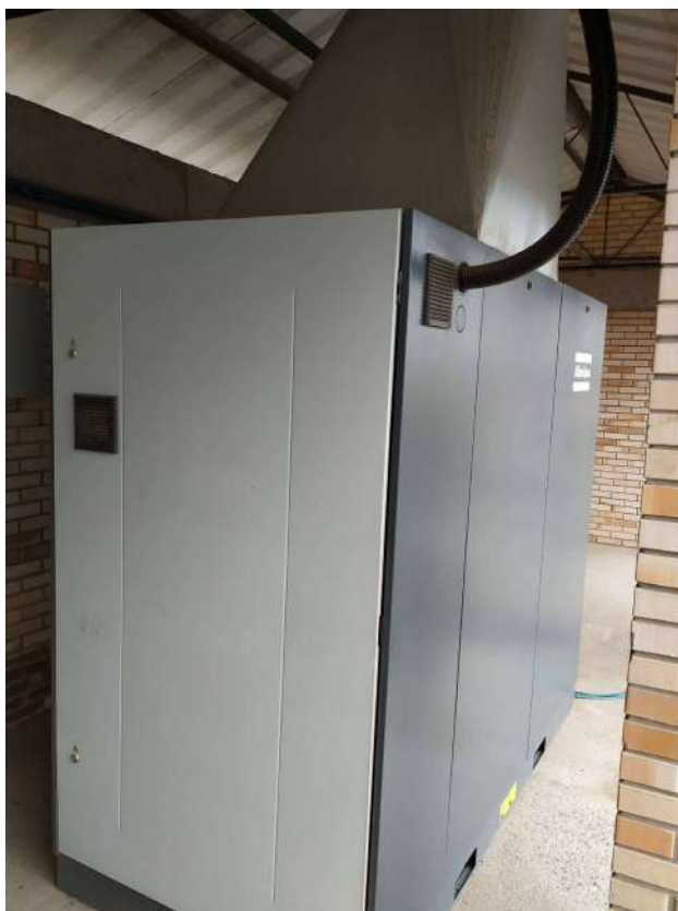
Foto 05: COMPRESSOR ESTACIONARIO GA55 150 AFF
