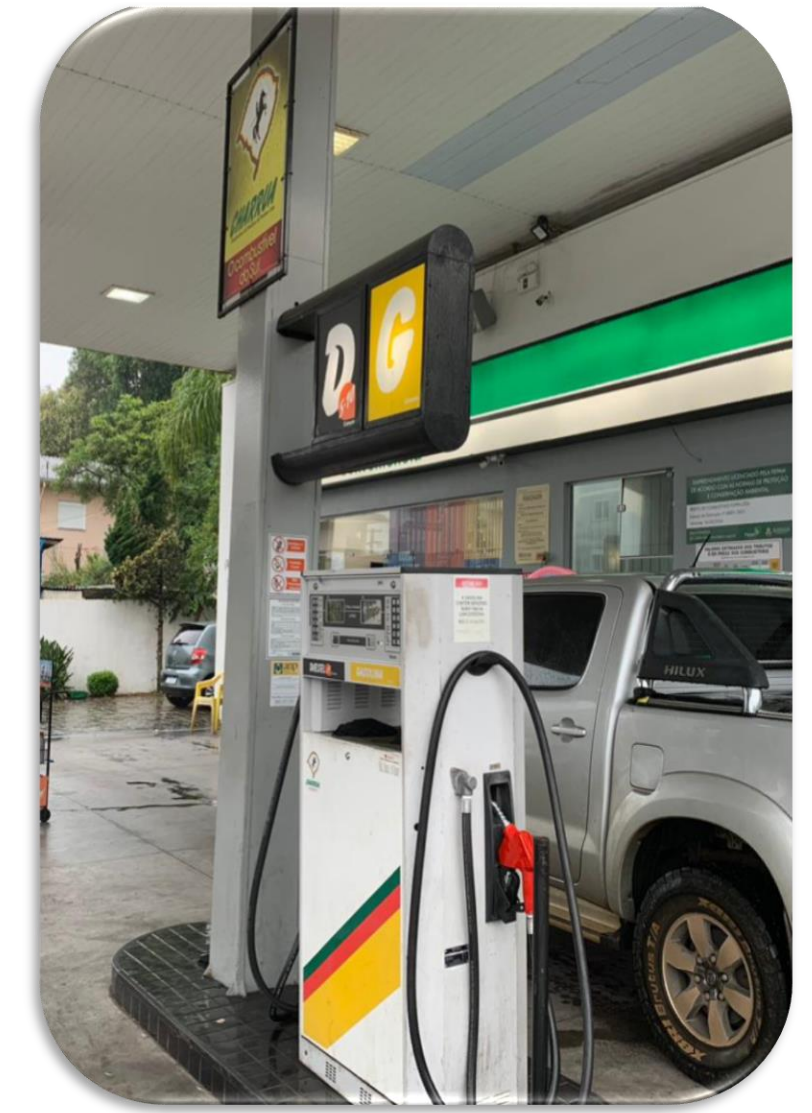
04. Bomba de abastecimento
