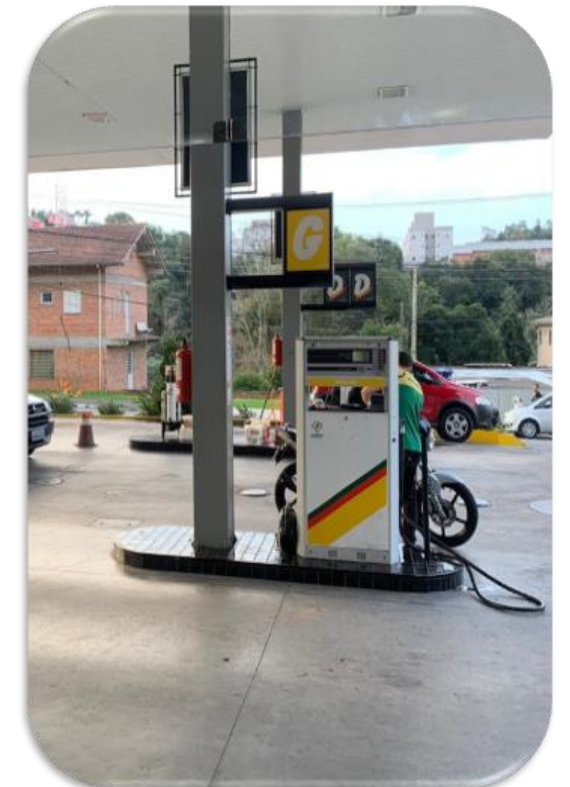
04. Bomba de abastecimento
